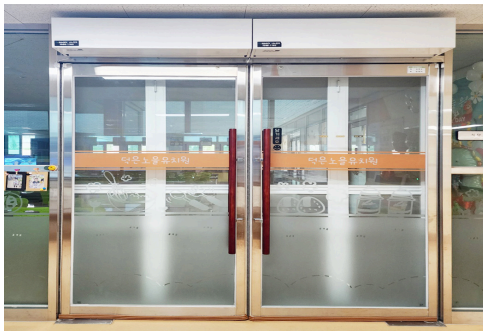
식당 출입구 에어커튼
